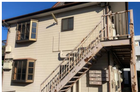
階段の崩落など、最近では修繕未実施による
